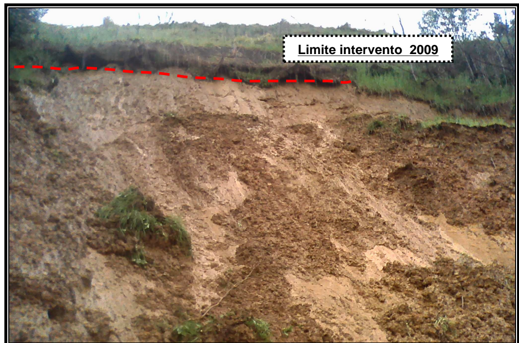
Foto n° 4 – scarpata e corpo di frana
