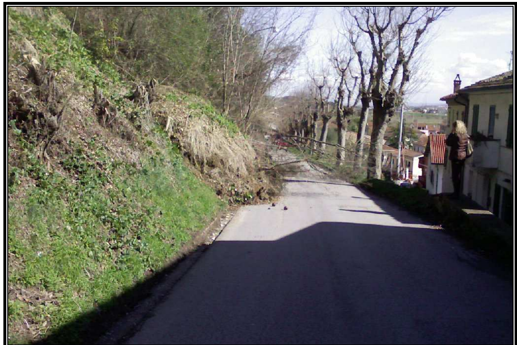
Foto n° 2 – corpo di frana
